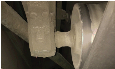
Falla de rodamientos. Desafíos del mantenimiento de la unidad de fijación.
